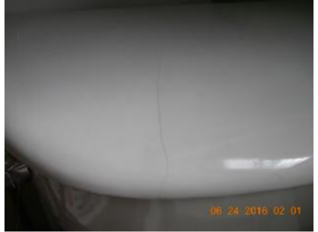
Broken tank lid
